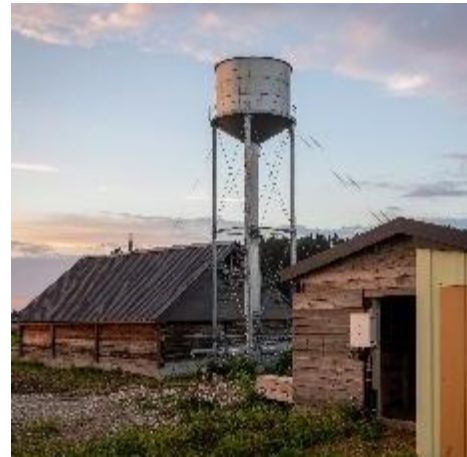
Tanques de almacenamiento
